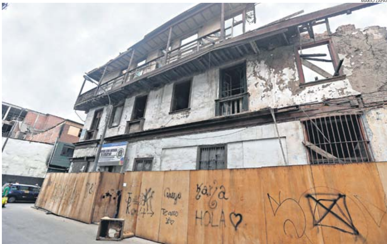
■ CALLEJÓN DEL BUQUE. Gran parte de su estructura se vino abajo tras un voraz incendio ocurrido en noviembre de 2012.
